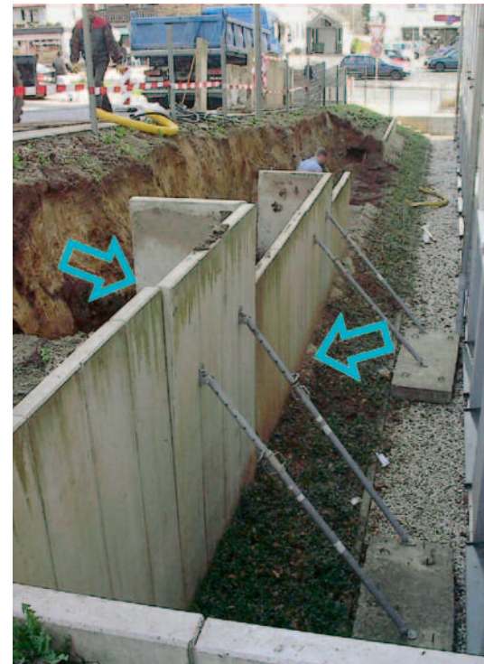
Vor Schadensbeseitigung sind zunächst zügige Dokumentationen des Bauzustandes und der Schadensursachen erforderlich.
